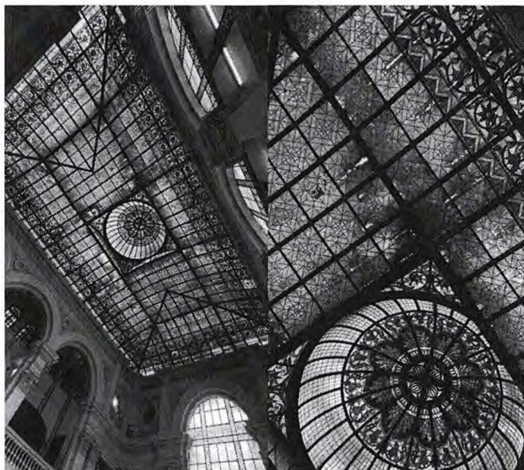
Actual estado de suciedad y deterioro del vitral del techo del edificio del Jirón Huallaga. Fuente: fotografía propia.
