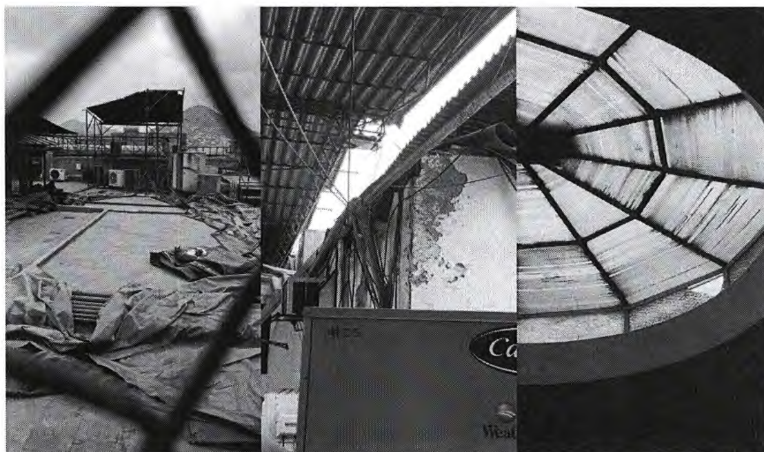
Deteriorado estado del techo del Palacio Legislativo. Fuente: fotografías propias.
