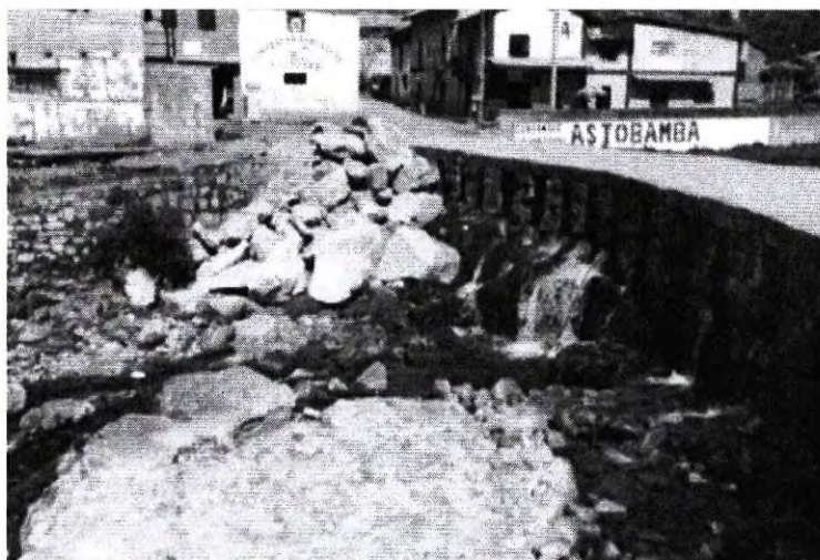
Afectación del puente de piedra del arqueológico Huarautambo /Andina.
