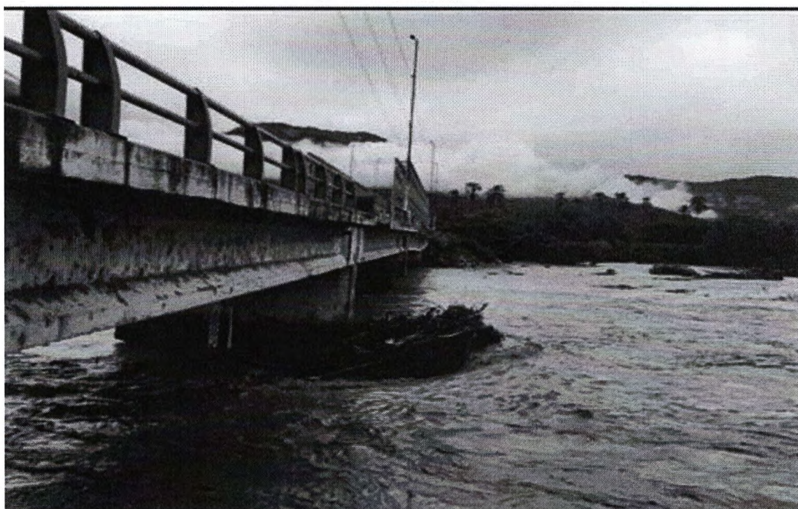
Vista de la maleza y sedimentos que golpean los cimientos del puente Fuente: Foto - Municipalidad distrital de Salitral, Provincia de Morropón, Región Piura
