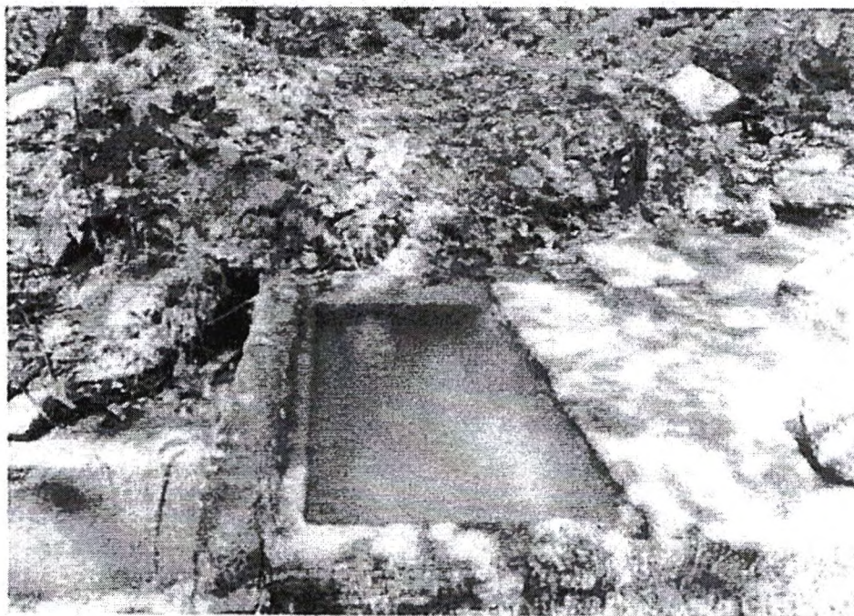
Fotografía N° 02: Fuente de Captación Cangrejal, en estado de descuido y abandono
