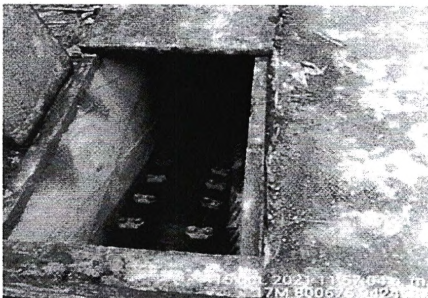
Fotografía N° 04: Tensores y arriostres cables deteriorados
