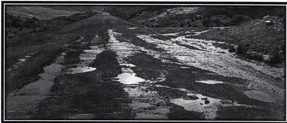
FUENTE: Deterioro del asfaltado Vial los Libertadores.
