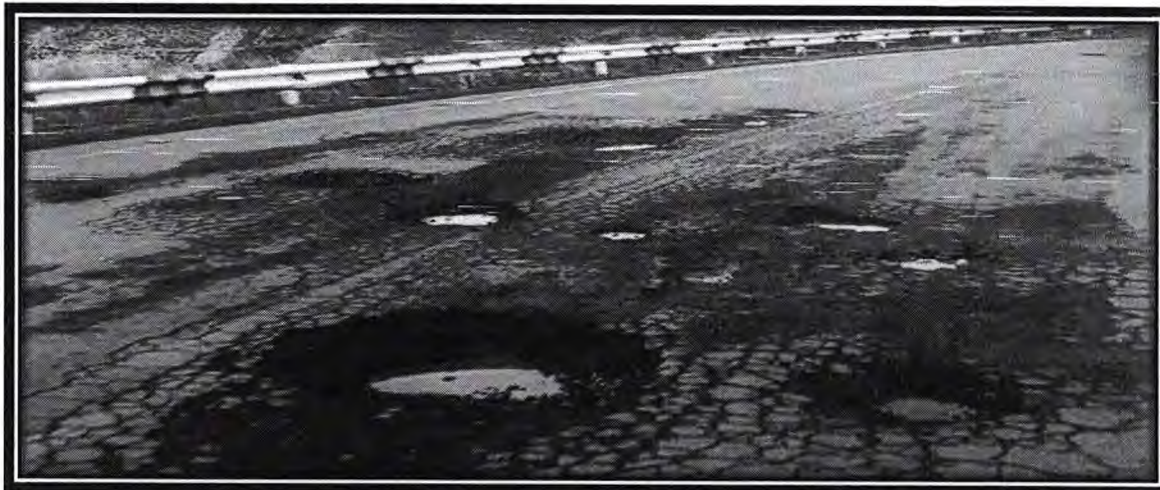
FUENTE: Oquedad y ahucamiento de la Vía Los Libertadores
