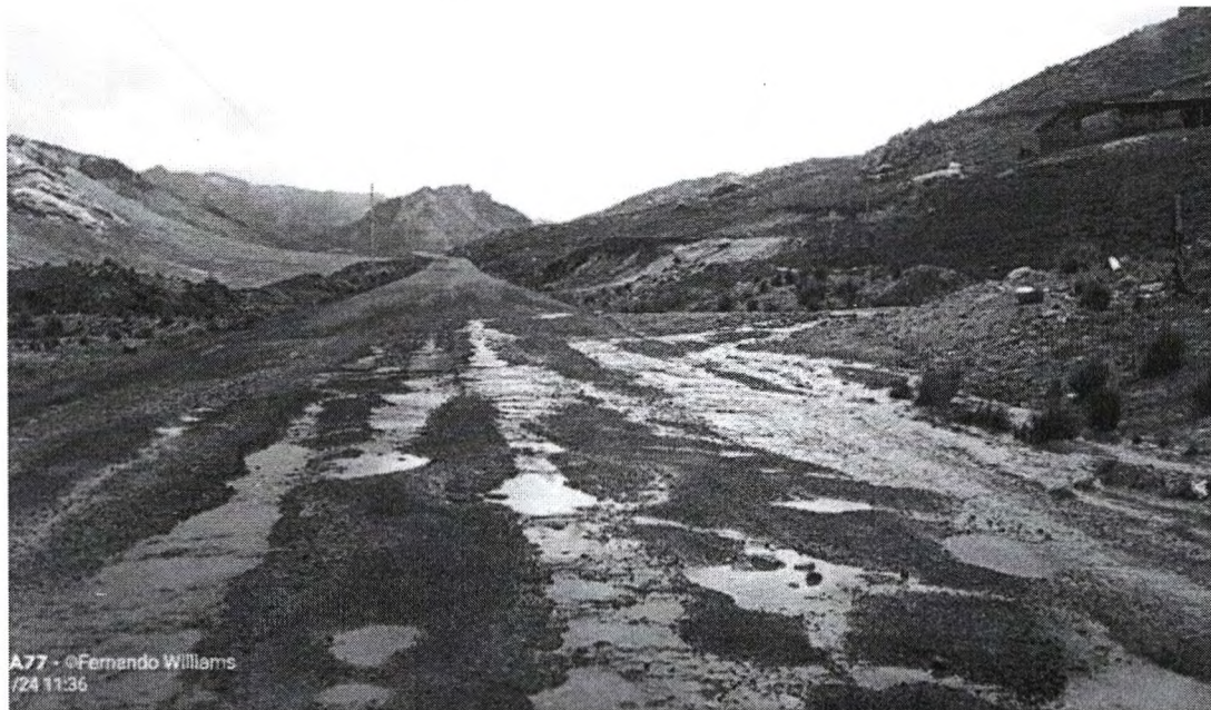
VIA LIBERTADORES DETERIORADA A CAUSA DE LAS LLUVIAS
