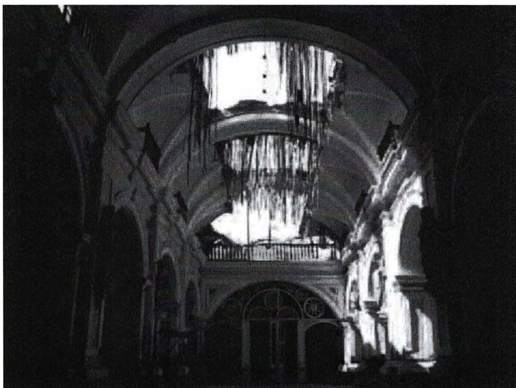
Vista interna de la Catedral de Ica donde se muestra los daños en la bóveda, de la nave en dirección al coro, sotacoro y la mampara del sotacoro
