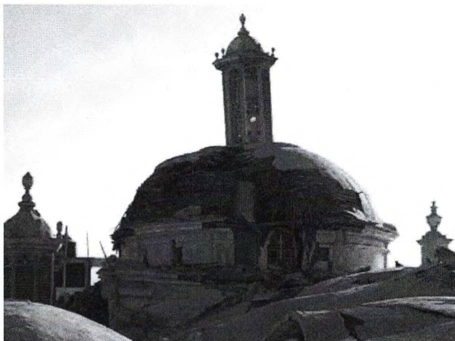
Vista externa del colapso parcial de la cúpula principal que muestra la caña brava y cubierta exterior
