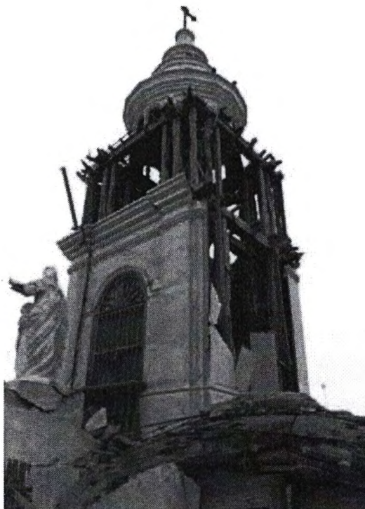
Vista externa de la Catedral de Ica donde se muestra la pérdida de revoque en el campanario del lado del Evangelio
