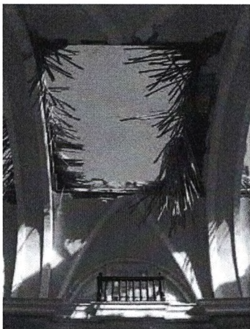
Vista interna de la Catedral de Ica donde se muestra la bóveda de cañón colapsada en una crujía de la nave principal
