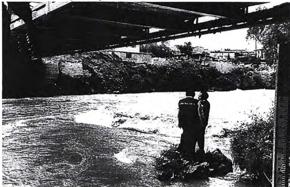
Fig. 5. Inspección de daños del Puente la Breña.
