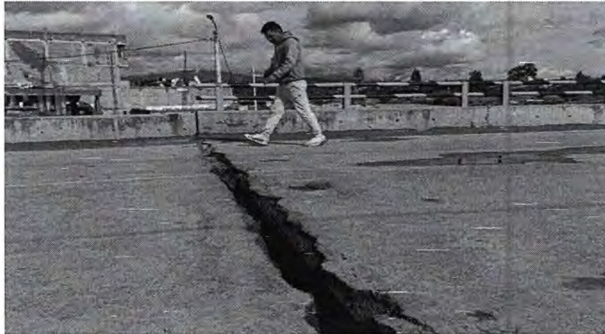
Figura 2: Puente Cunas con daños materiales severos, al borde del colapso
