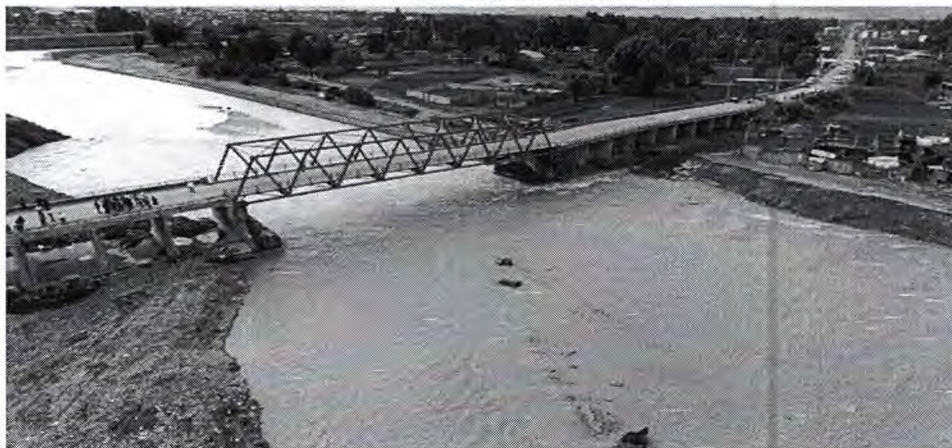
Figura 1: Río Cunas situado en el departamento de Junín, el mismo que a la fecha tiene severos daños materiales
