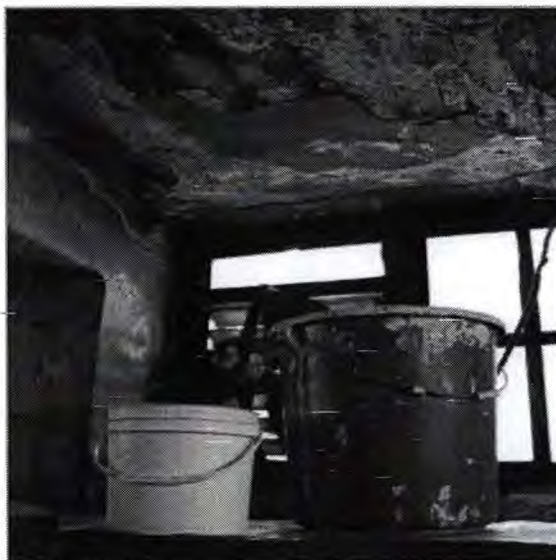
Imagen N° 3: Grietas en la pared y columna de los ambientes del AGN a causa de la filtración de agua y humedad - Sótano del Palacio de Justicia.
