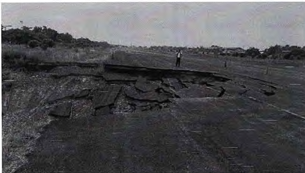
Erosión en la pista de aterrizaje del aeropuerto de Yurimaguas en febrero pasado. Foto: Contraloría
