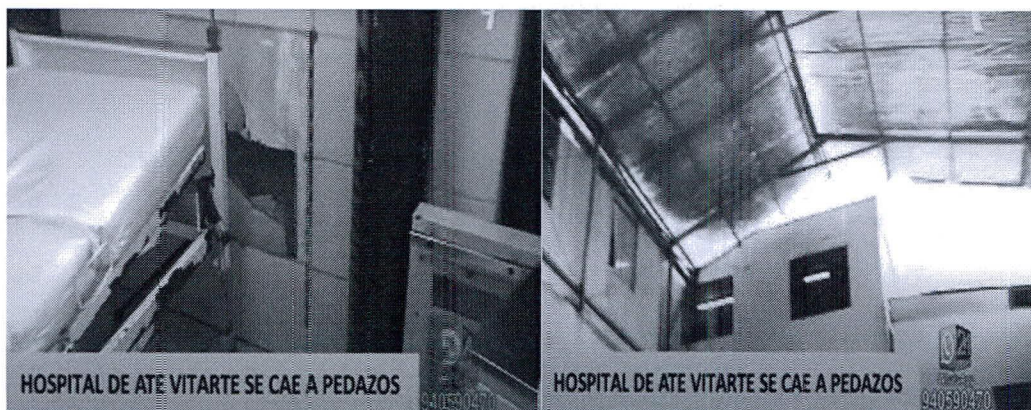
Infraestructura interna del Hospital Vitarte 15 .
