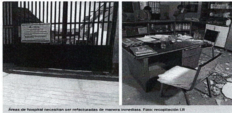
Áreas de hospital necesitan ser refacturadas de manera inmediata. Foto: recopilación LR
