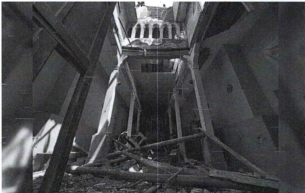
Figura No 12 Hospital Regional Docente Las Mercedes de Chiclayo capilla derruida – toma interna
