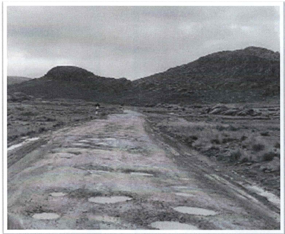
Carretera con huecos y desniveles Puquio -Corocora
