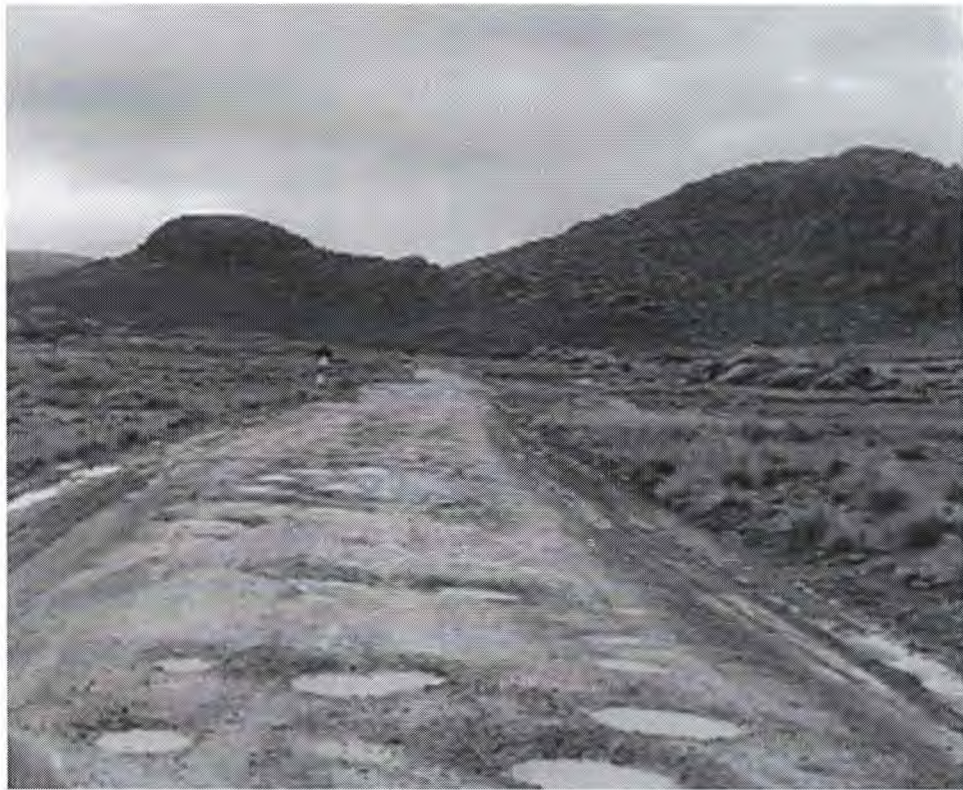
Carretera con huecos y desniveles Puquio -Corocora
