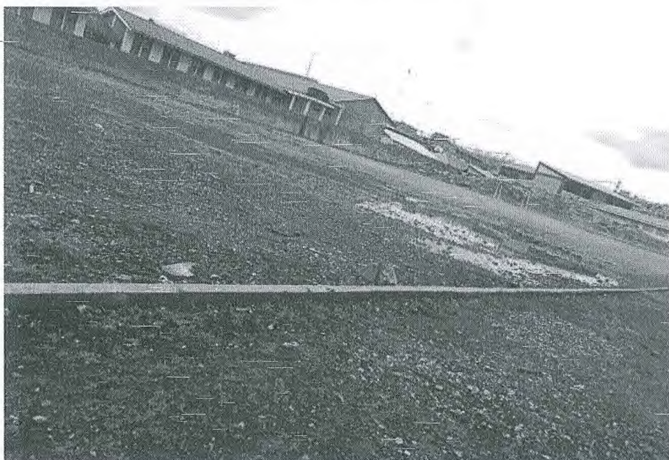
Campo deportivo completamente deteriorado
