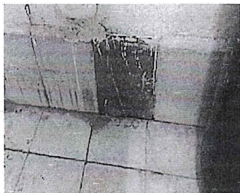
SERVICIO DE HOSPITALIZACIÓN DE MEDICINA, Piso y contra zócalos presentan desgaste por el tiempo - hospital II Cañete EsSalud
