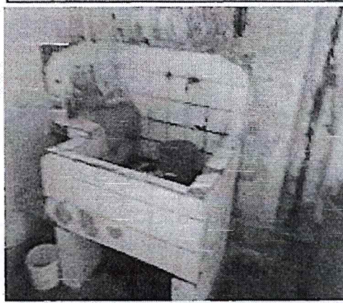
Estado actual que se encuentra el lavadero de servicio del Centro de Rehabilitación Integral de Pacientes Crónicos (CRIPC)
