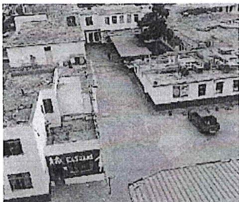
Se evidencia los ladrillos de los techos, se encuentran en mal estado, presentan desgastes que ocasionan hundimientos y descascarado del techo en los interiores de los servicios.
