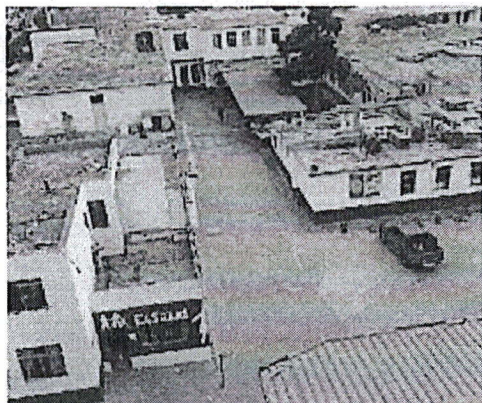
Se evidencia los ladrillos de los techos, se encuentran en mal estado, presentan desgastes que ocasionan hundimientos y descascarado del techo en los interiores de los servicios.
