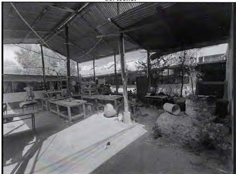
Fotografía 6. Zona con mucha acumulación de aguas de lluvia, por la mala instalación del techo.
