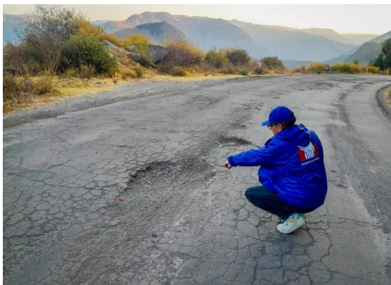
Fuente: Defensoría del Pueblo. Carretera no cumple con especificaciones técnicas.
