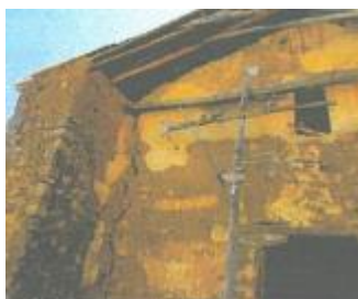
Fachada del templo colonial San Felipe de Mulca, Mostrando su verdadera expresión por los años pasados y el desgaste de material piedra con barro
