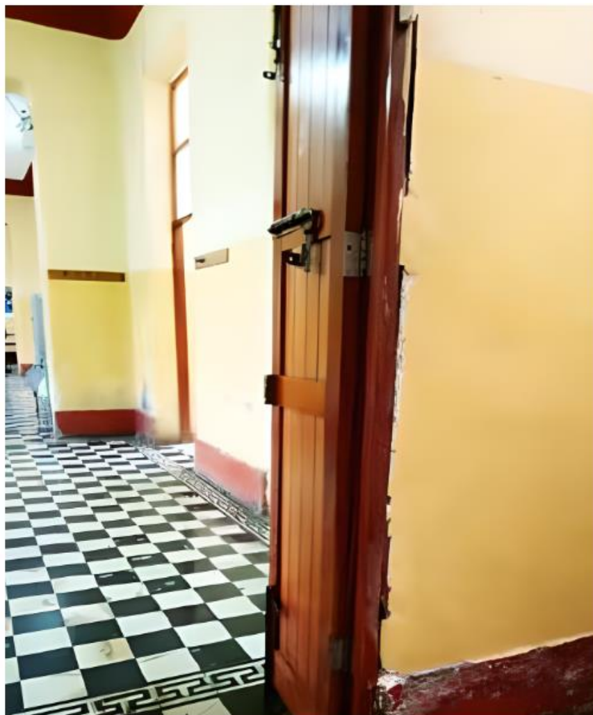
Advierten desgaste en la infraestructura del hospital. Pabellones resquebrajados. Foto: Defensoría.
