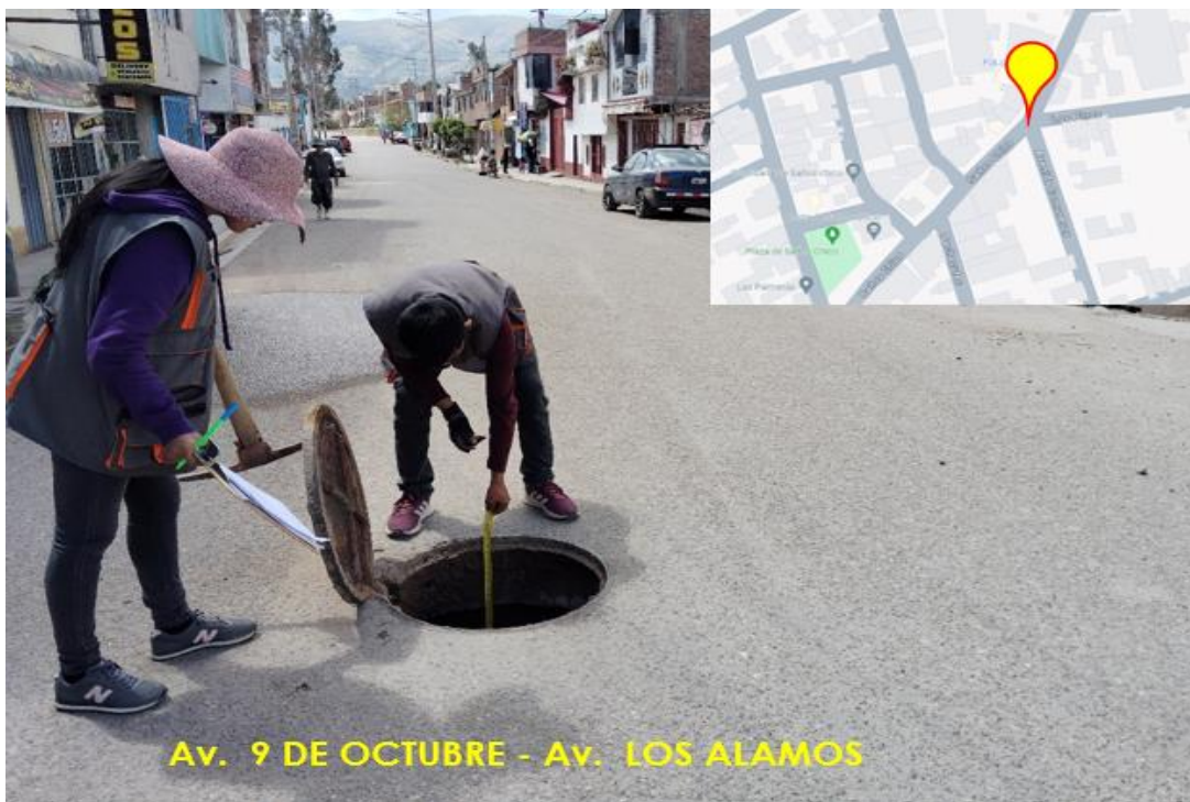
Fotografía 5. Red recolectora con diámetro de 250 mm, por debajo del estándar, lo que lleva a que este sistema colapse. Av. 9 de Octubre y Av. Los Álamos
