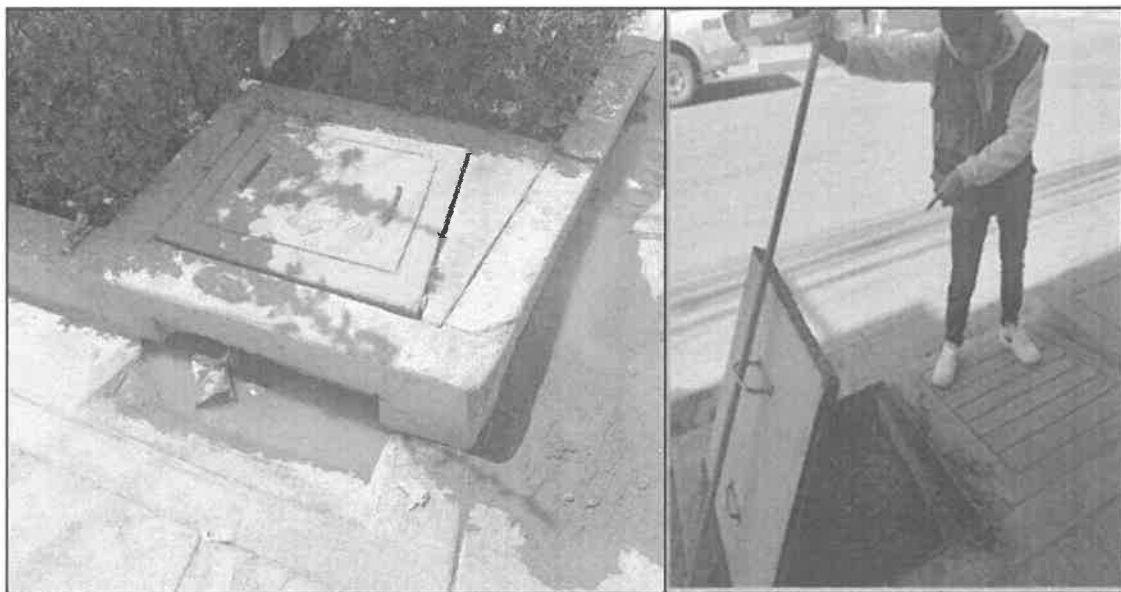
Fotografía 2: Sistema de alcantarillado pluvial saturado en la Av. Miguel Grau y Jr. Circunvalación (2024)
