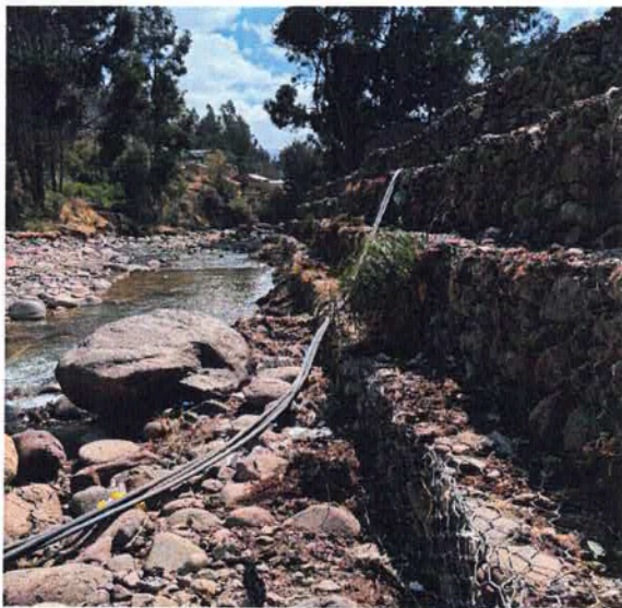
FIGURA N°07: GAVIONES EXISTENTES CONSTRUIDOS POR EL PROGRAMA TRABAJA PERÚ, SIN EL CRITERIO TÉCNICO, EN MAL ESTADO
