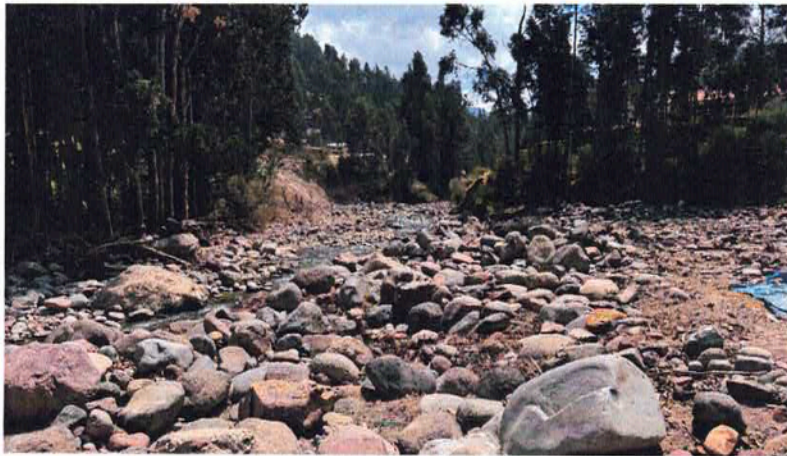
FIGURA N°04: SE EVIDENCIA LAS VIVIENDAS QUE SE ENCUENTRAN EN LA MARGEN DERECHA DEL RIO EN UN PELIGRO DE SOCAVAMIENTO.
