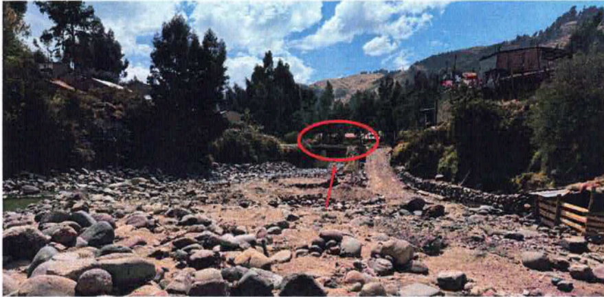
FIGURA N°03: SE EVIDENCIA EL SOCAVAMIENTO DE TALUD POR EL INCREMENTO DEL CAUDAL ASI MISMO SE EVIDENCIA UN PUENTE POR LO QUE EN TEMPORADAS DE LLUVIAS SE ENCUENTRA EXPUESTO ANTE UN COLAPSO.
