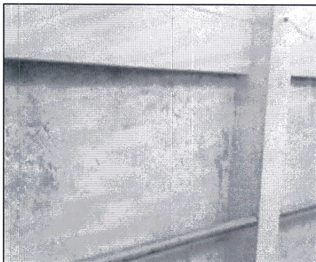
PRESENCIA DE HUMEDAD EN PARED HIZO QUE LA PINTURA SE DETERIORE (SEGUNDO NIVEL)
