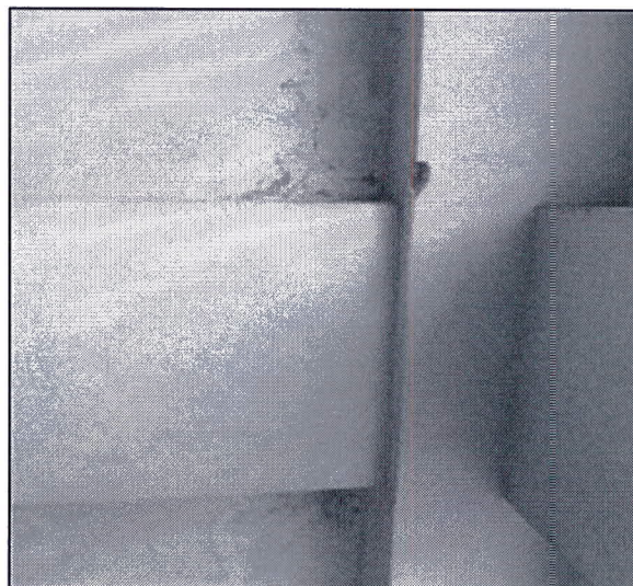
FISURAS EN INTERSECCIÓN ENTRE LA COLUMNA Y VIGA (SEGUNDO NIVEL)
