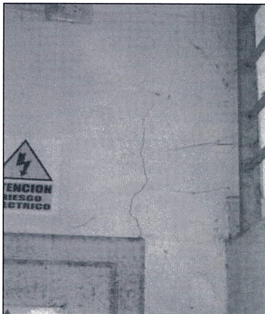
RAJADURAS DE PARED CERCANAS A INSTALACIONES ELECTRICAS, CON ALTO PELIGRO DE CORTO CIRCUITO
