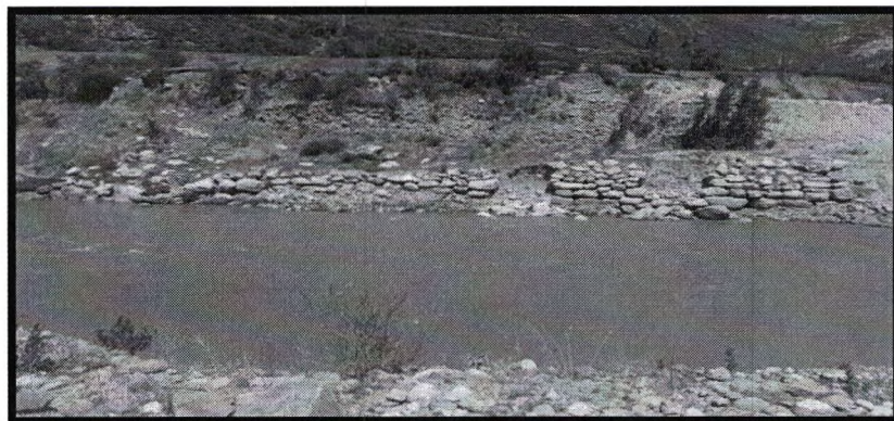
IMAGEN N°04: SE PUEDE APRECIAR PARTE DEL ESTRIBO DEL PUENTE AFECTADO POR EL DESLIZAMIENTO DE CUENCA.
