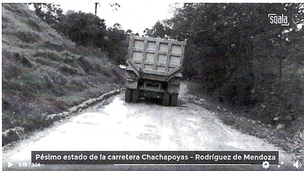
Gráfico N° 02: Pésimo estado de la carretera Chachapoyas – Rodríguez de Mendoza
