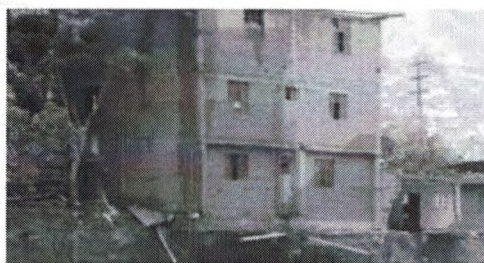
Casa colapsa por huaico en Chosica
